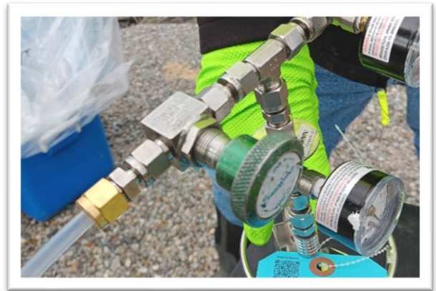
*Figure 11e - Open Effluent Valve
